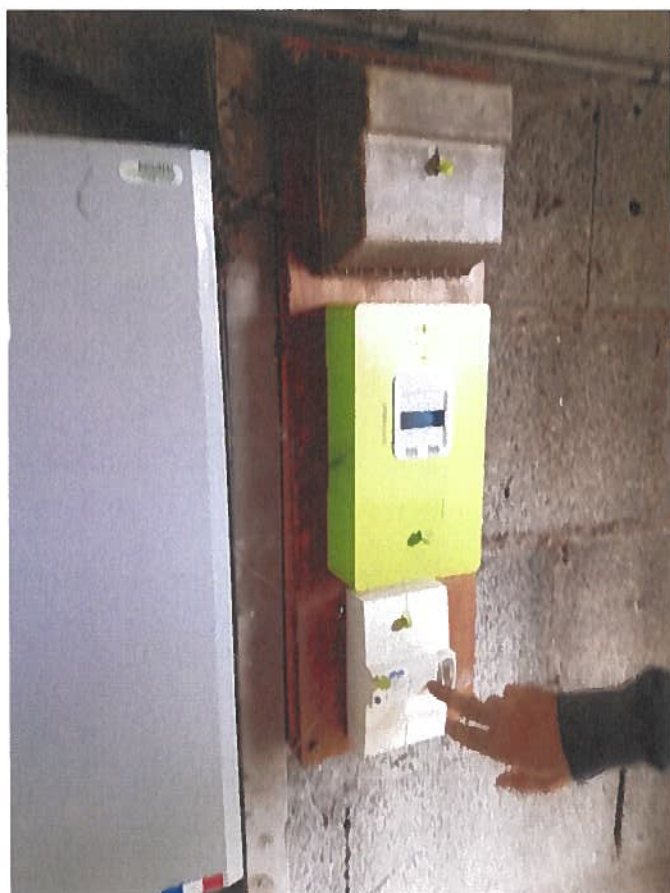
Compteur électrique général.
